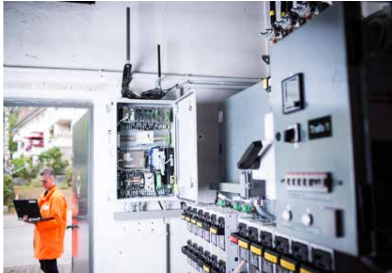
Die fachmännische Installation des Smart-Grid-Systems übernimmt der Energiedienstleister SAG GmbH
